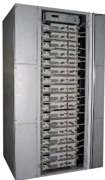
Шкаф транзисторного передатчика
