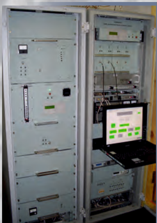
Шкаф передатчика Шкаф приема и обработки сигнала
