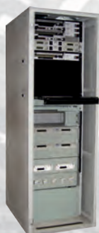
Шкаф обработки сигналов
